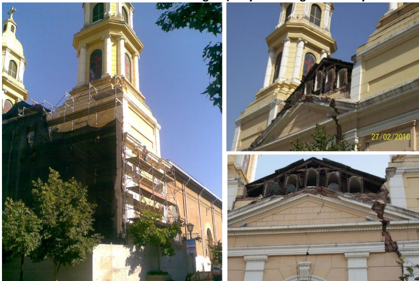
Fotografía N° 9 Daños a la Catedral de Rancagua (Proyecto acogido a la Ley de Reconstrucción)
